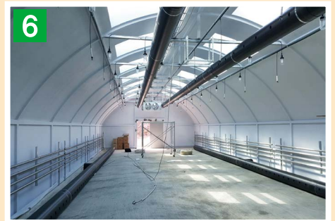
재배사 내부 공조시설
